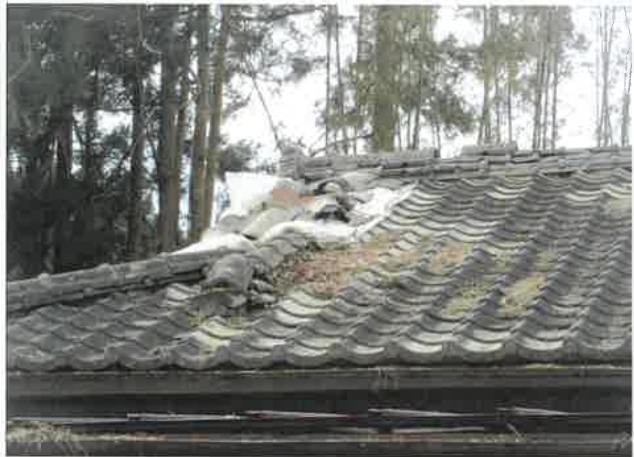
物件3:屋根瓦の破損した状況
