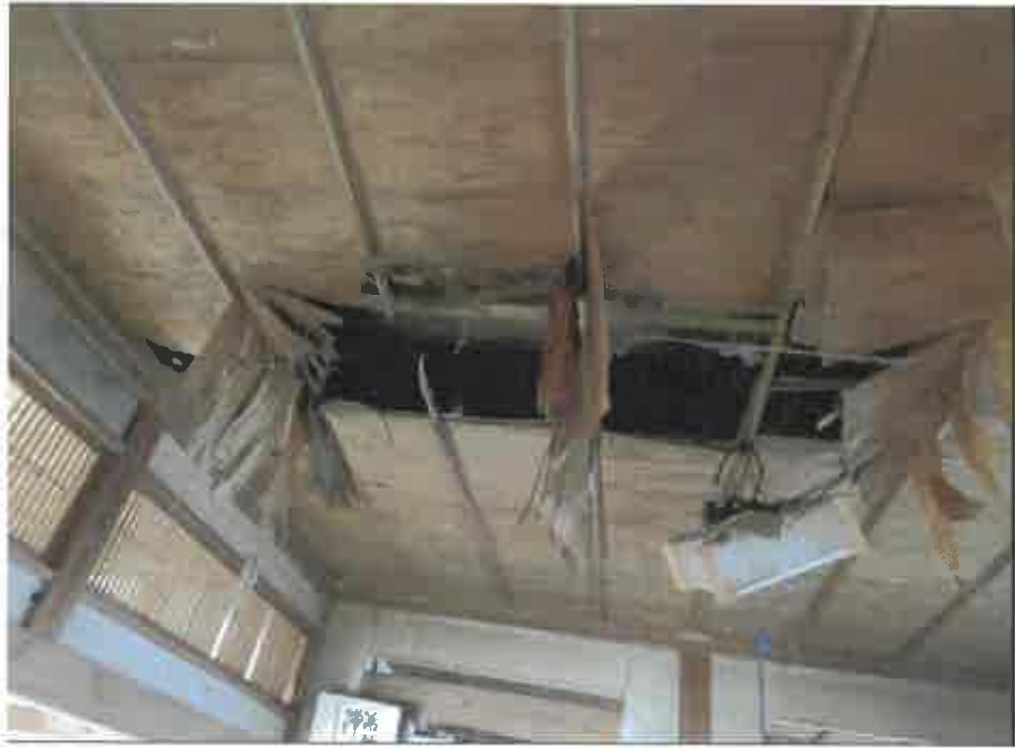
物件3: 部屋③の天井の状況
