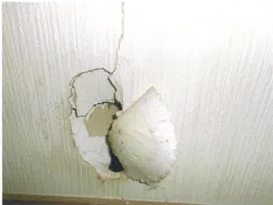
物件2:1階階段下壁面の状況
