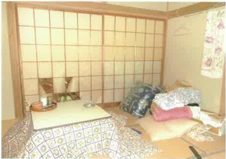
物件7主である建物:湯治棟2 客室513の状況
