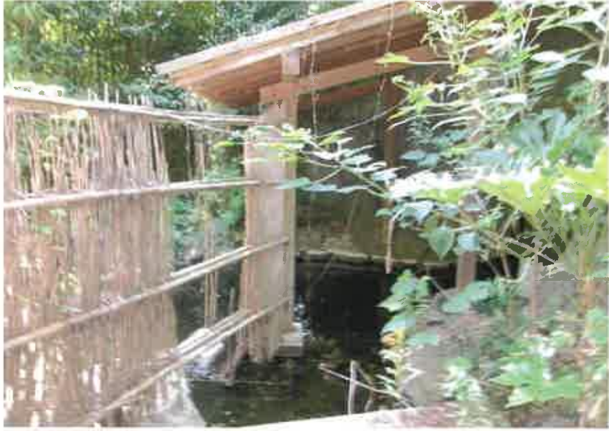
物件7主である建物:湯治棟2 脱衣室女から洞窟風呂を撮影
