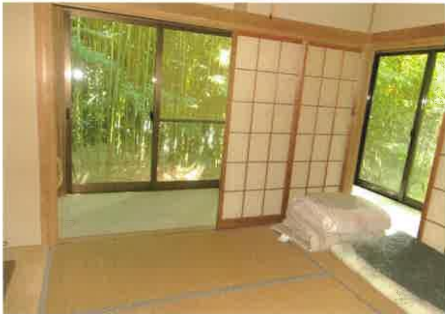
物件7主である建物:湯治棟2 客室511の状況
