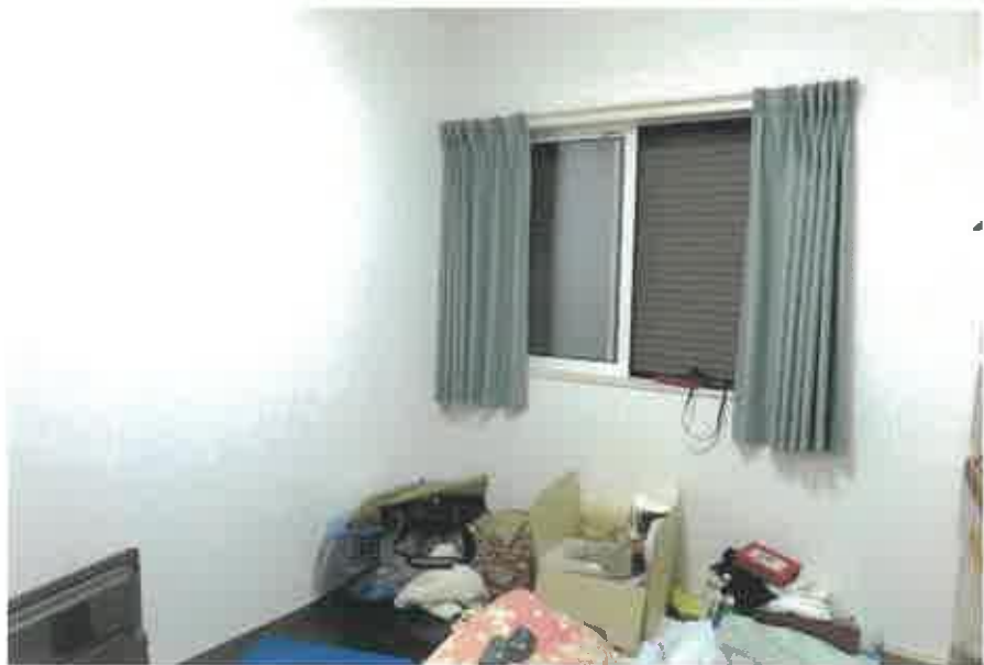
物件2:西側洋室の状況
