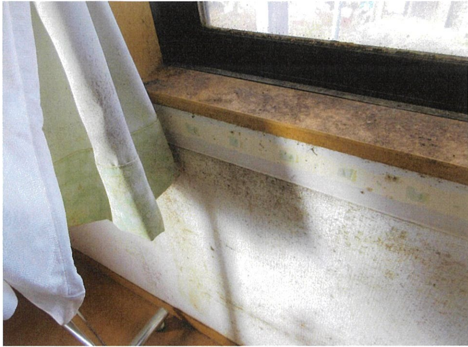
物件3:2階北西側洋室の北側の窓付近の汚損状況
