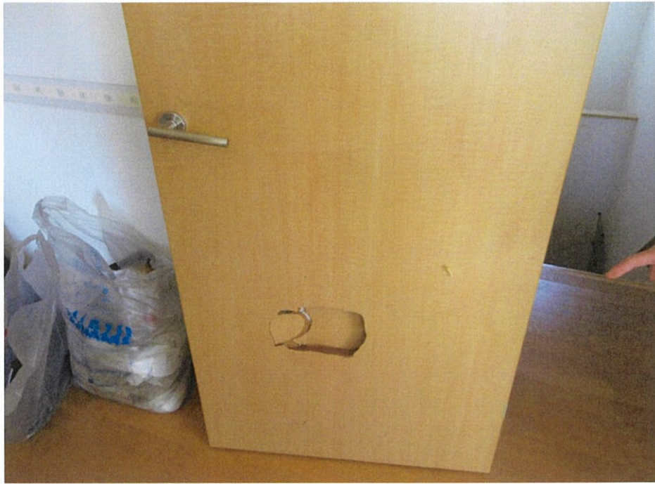
物件3:2階南西側洋室のドアの損傷の状況 No. 13
