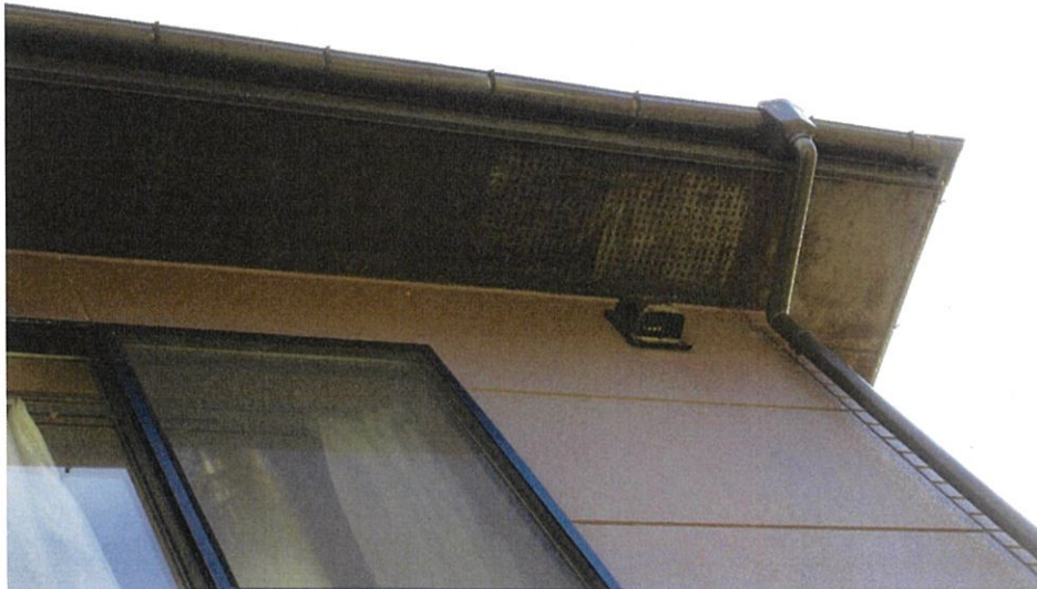
物件3:軒天の汚損の状況 No. 14
