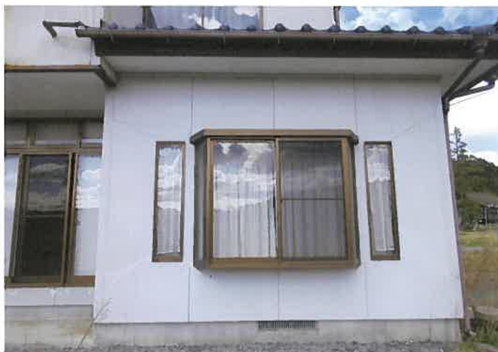
物件6:外壁のひびの状況等
