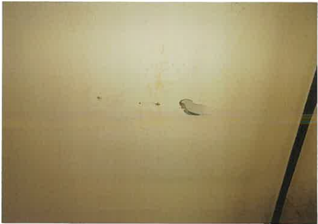
物件6:2階東側洋室の天井の破損等の状況
