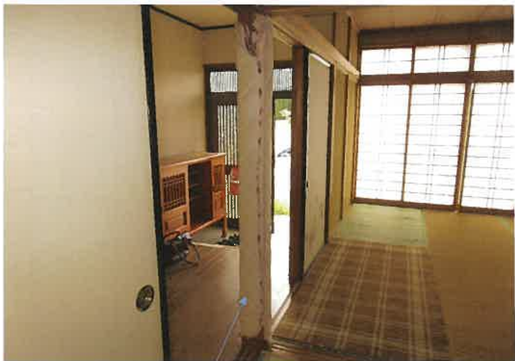
物件6:1階の西側和室と北側和室の間にある、縦に割れが生じている柱
