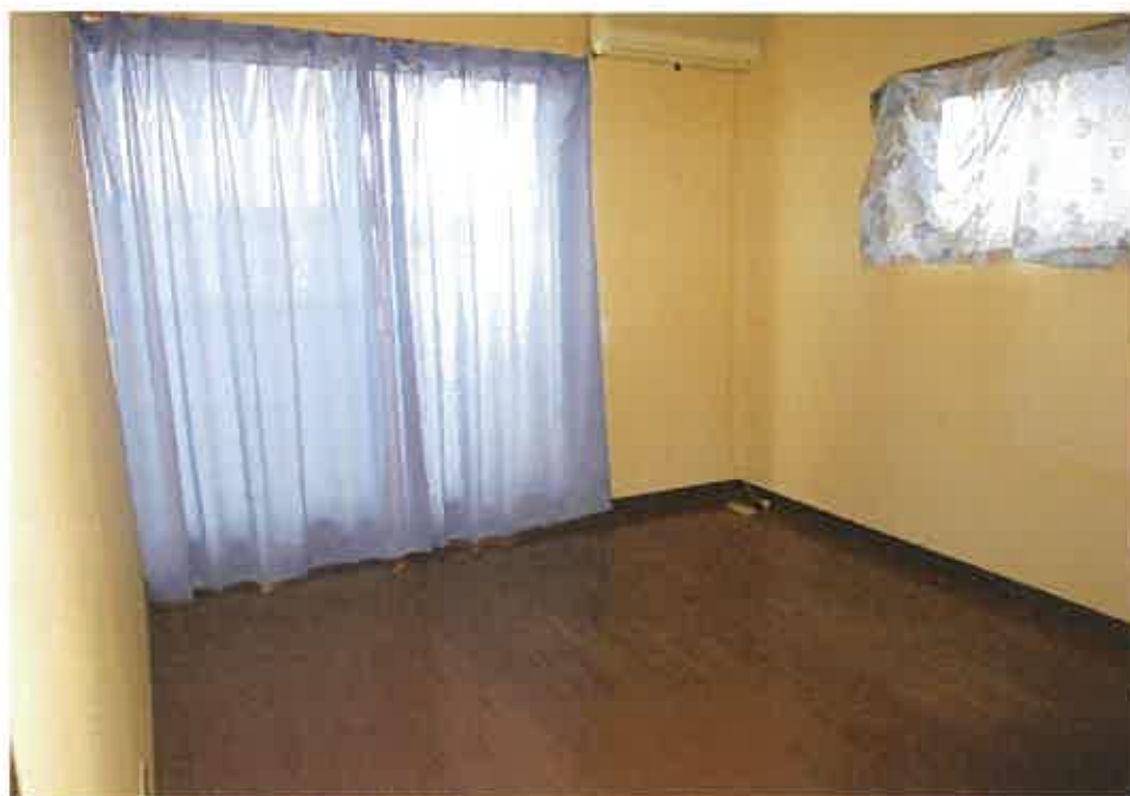
物件2:2階西側洋室の状況
