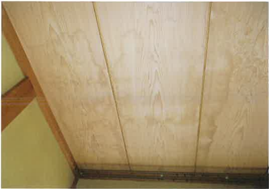
物件6:1階西側和室の天井のしみの状況
