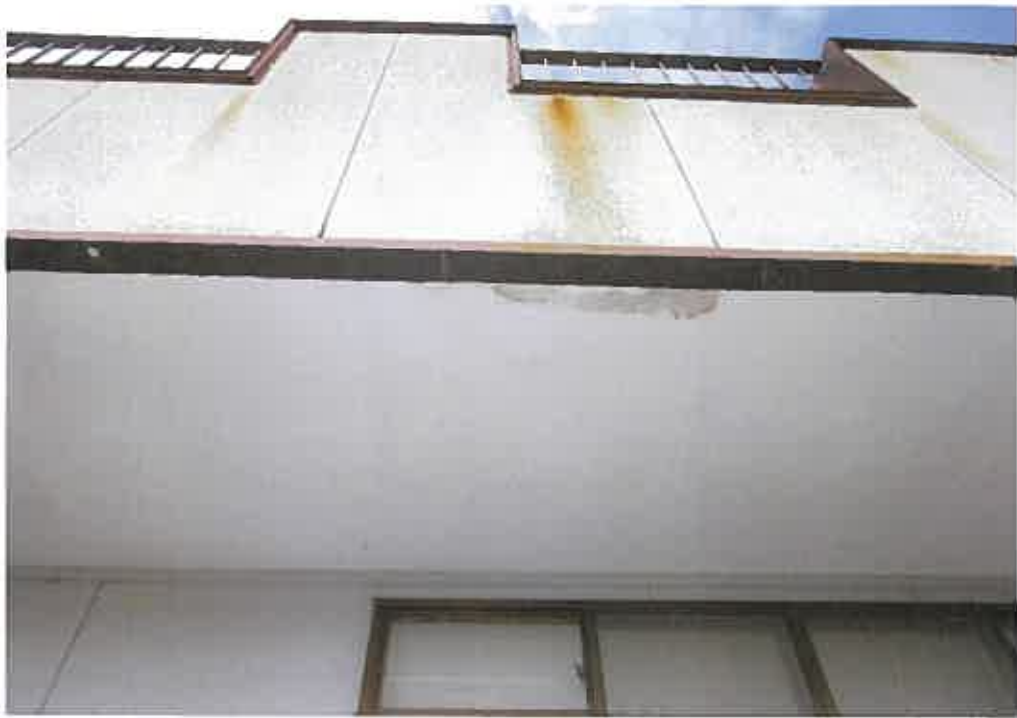
物件6:ベランダ下側部分のしみ等の状況
