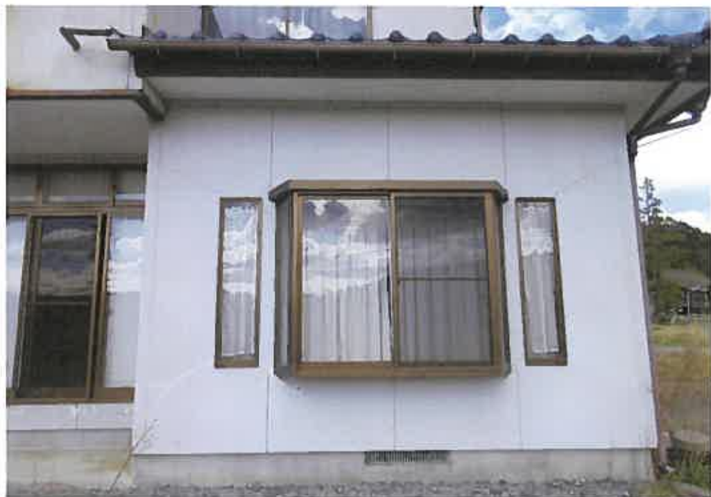
物件6:外壁のひびの状況等
