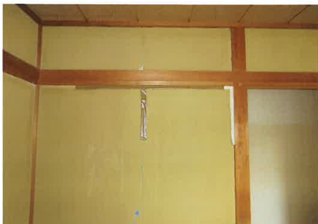
物件6:1階板の間のある和室の内壁のひび等
