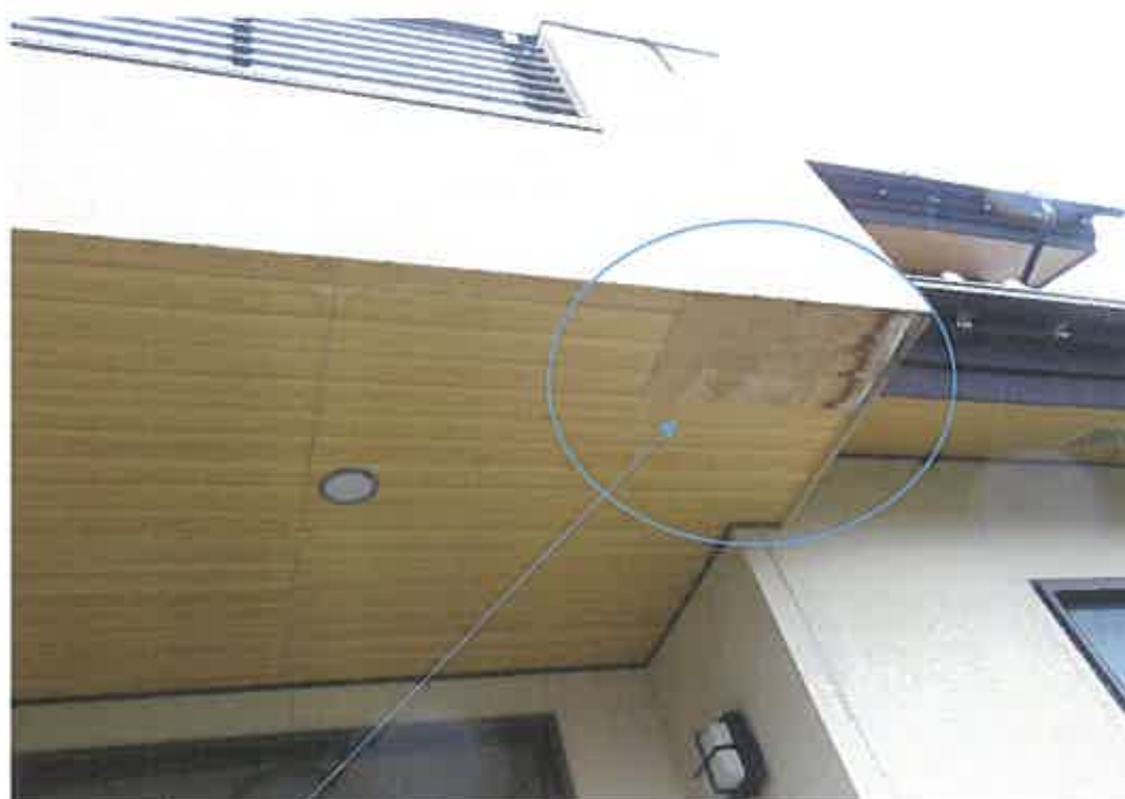
玄関ホーチ部分の軒天の損傷
