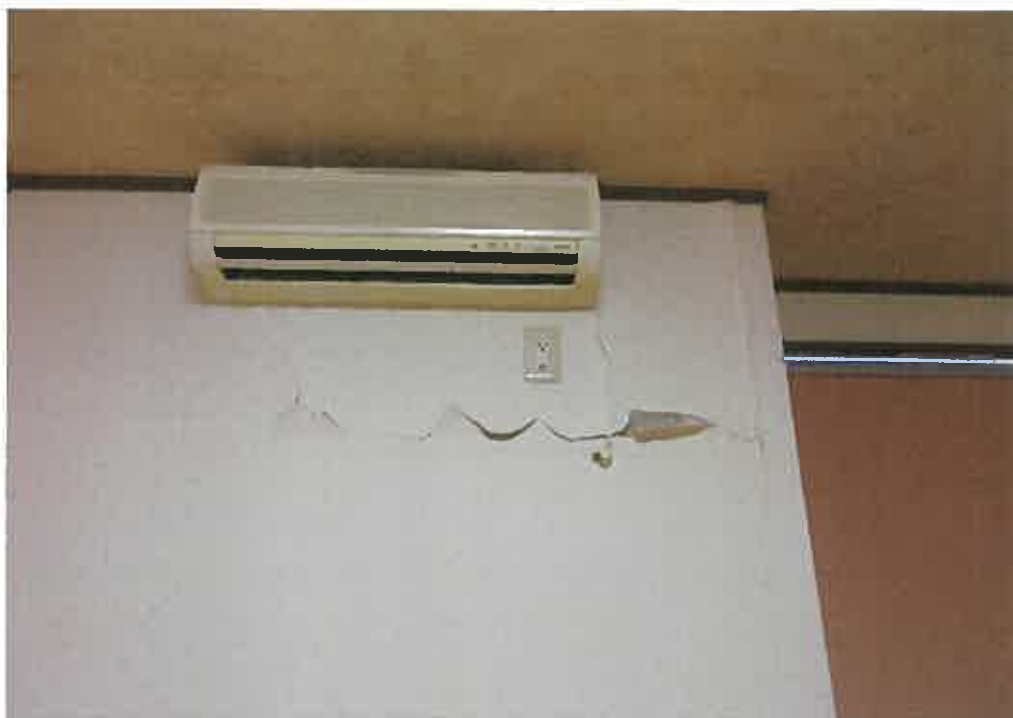
物件3:2階北側洋室の内壁クロスの損傷等の状況
