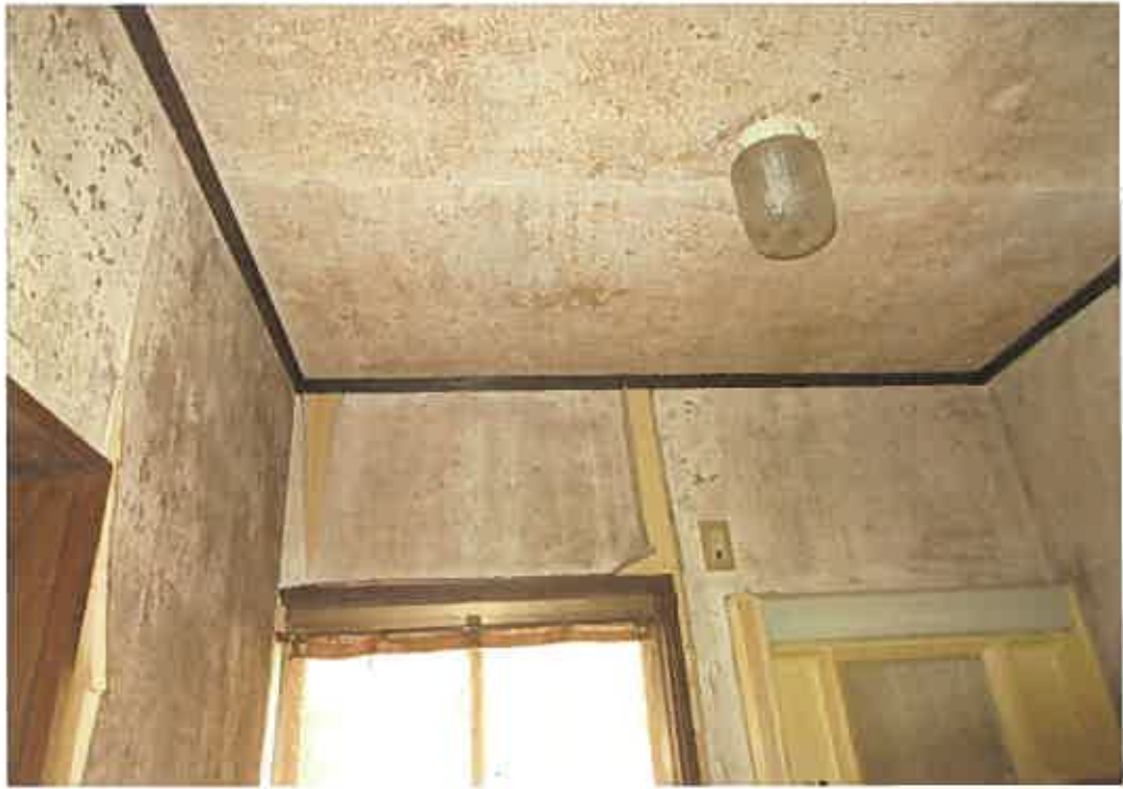
物件2主である建物:1階洗面脱衣室の内壁 や天井のしみ等の状況
