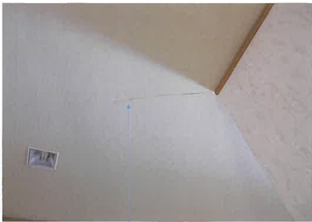
廊下の天井クロスのひび
