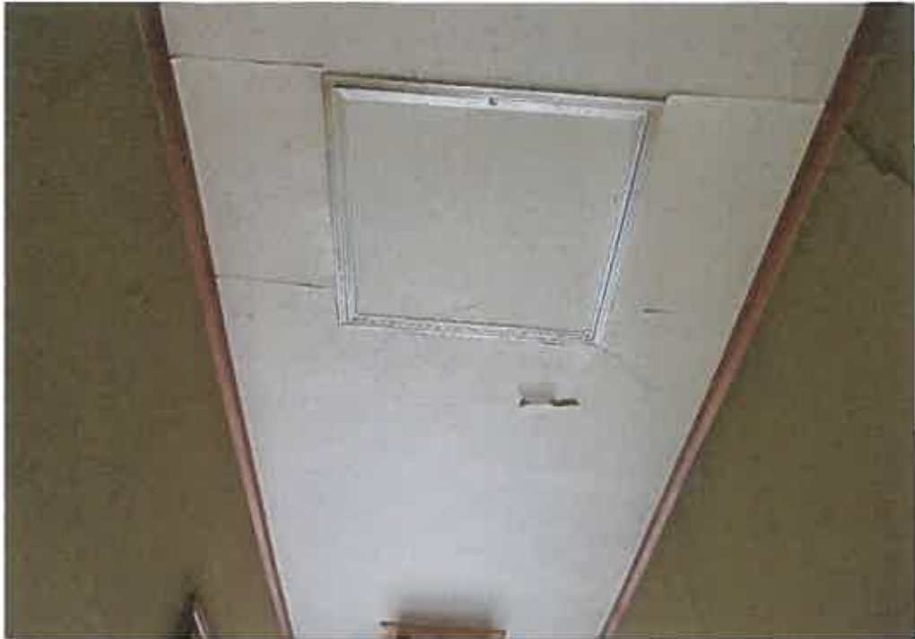
物件12:1階廊下の天井等のひびの状況
