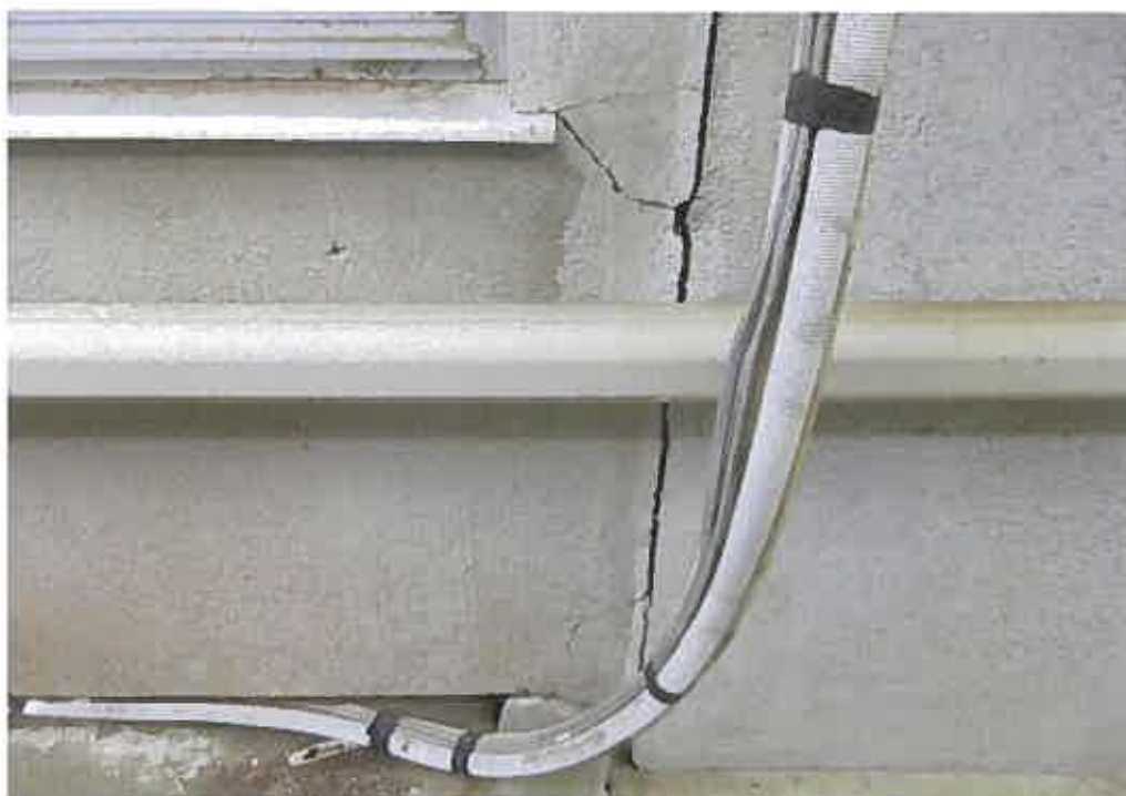
物件12:外壁のひび等の状況
