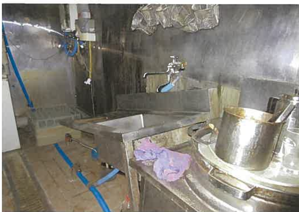
物件12:1階厨房の流し台の損傷等の状況
