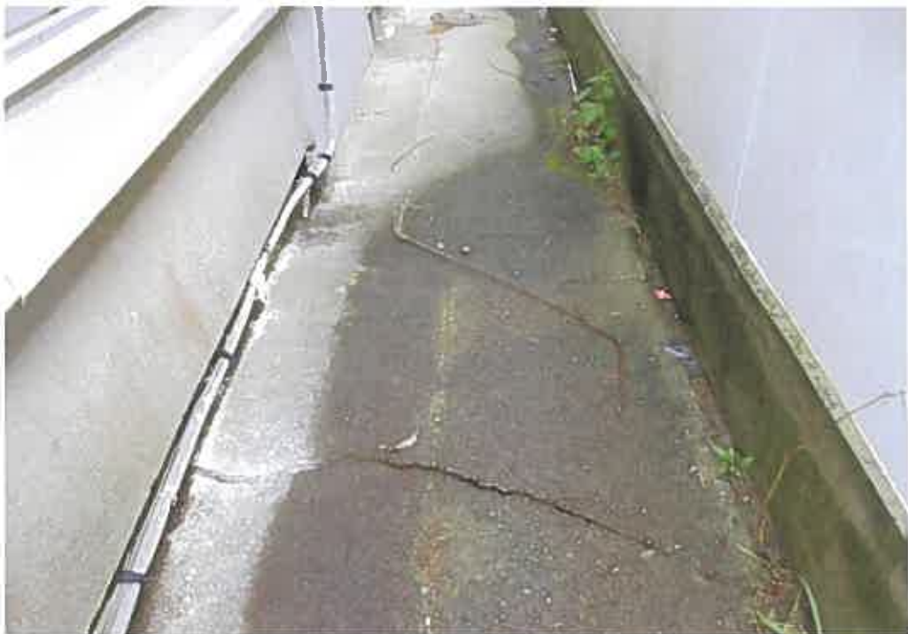
物件1:コンクリート部分のひびの状況
