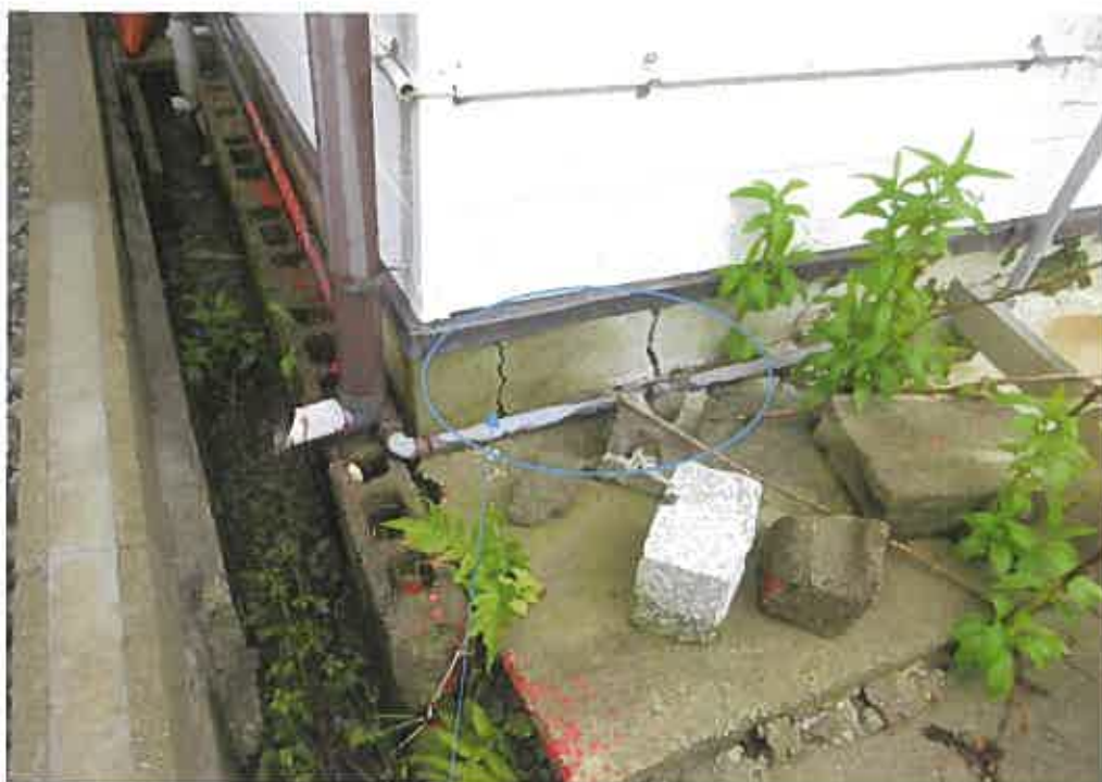
物件12:土台のひび
