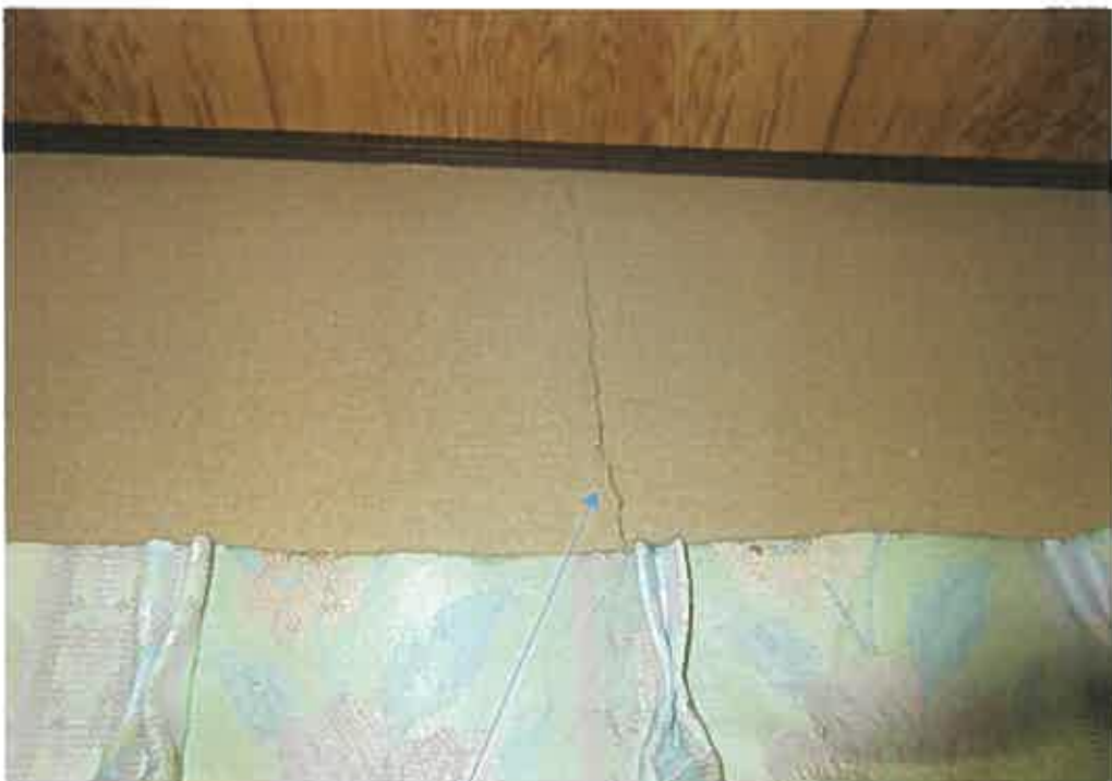
物件12:2階廊下の内壁のひび
