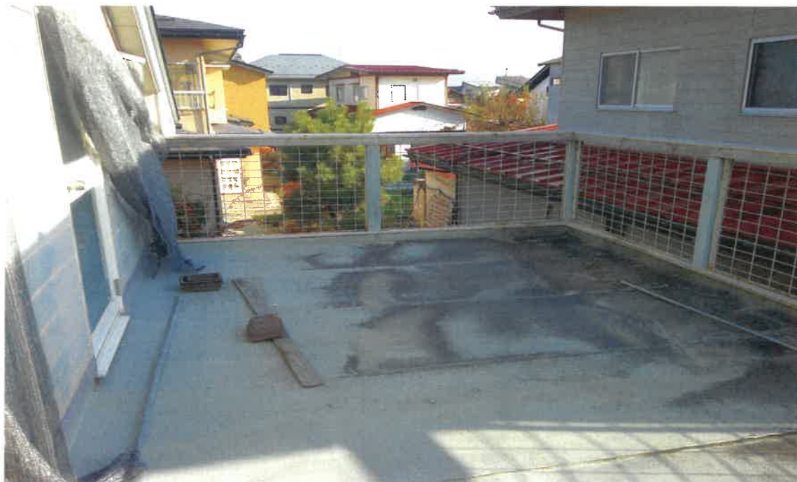
写真⑨(物件3 バルコニー 2階)
