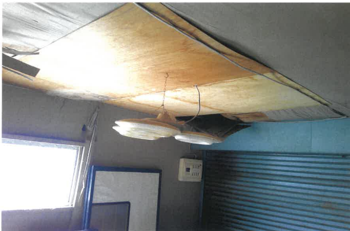
写真⑨(物件2 1階 車庫・物置天井)
