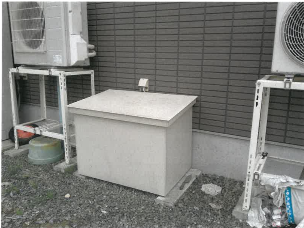
写真⑥ (物件2 井戸ポンプ)
