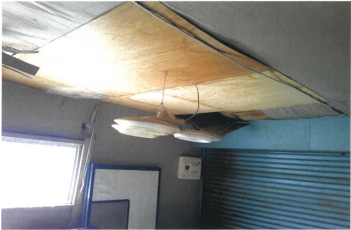
写真⑨ (物件2 1階 車庫・物置天井)
