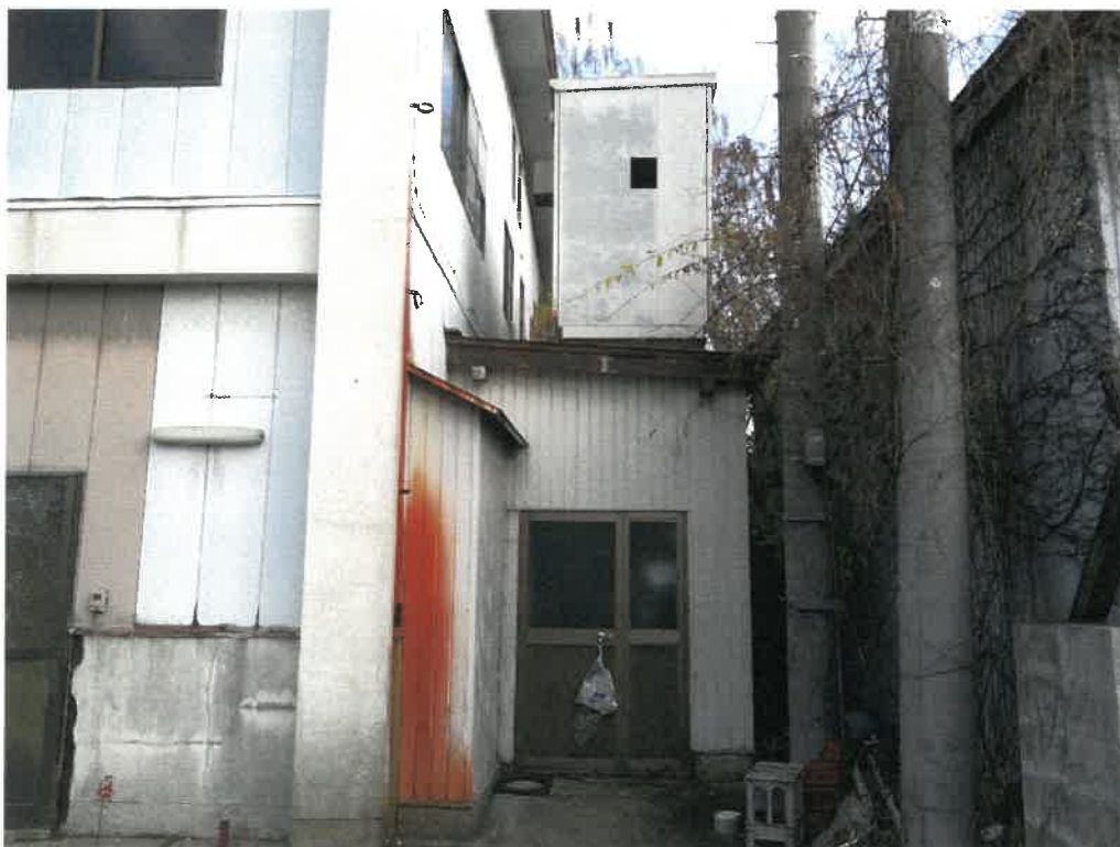
写真④ (物件4 冷却ダクト)
