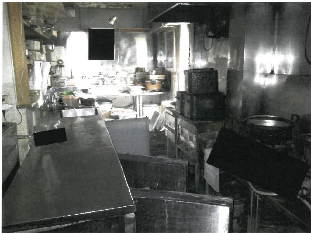
写真⑤(物件4 1階店舗(厨房))
