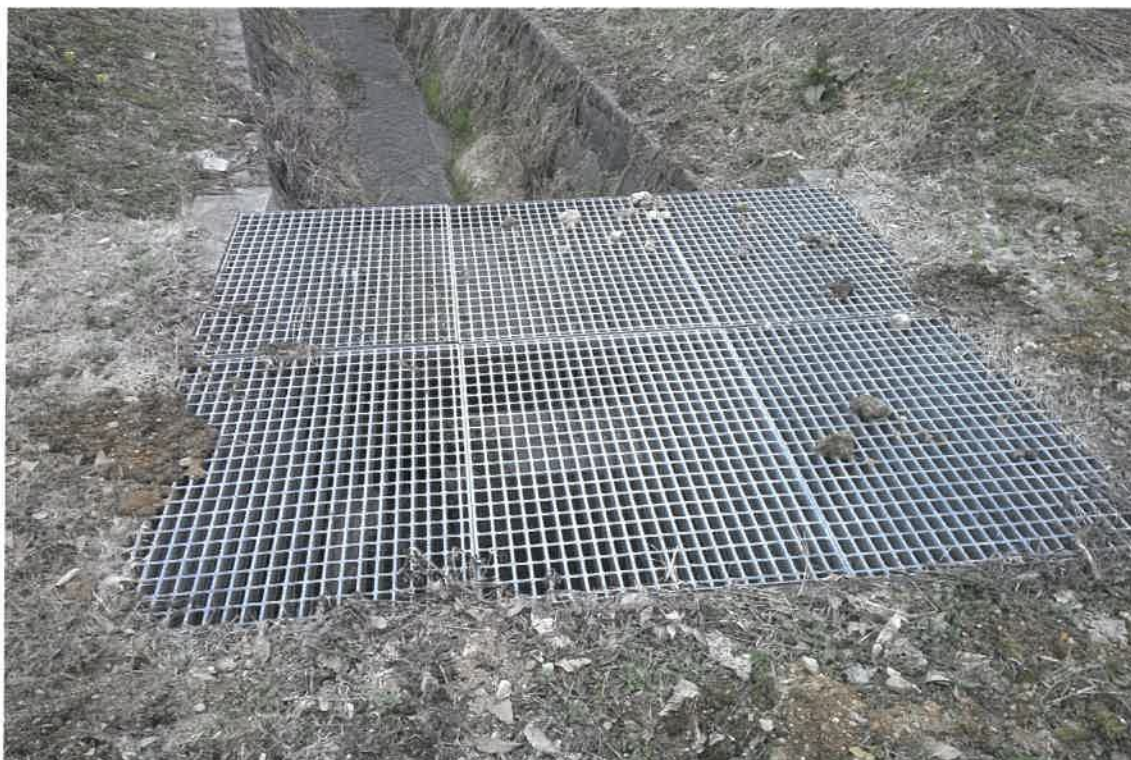
写真⑫(物件1 積雪が解けた後の水路のグレーチング)
