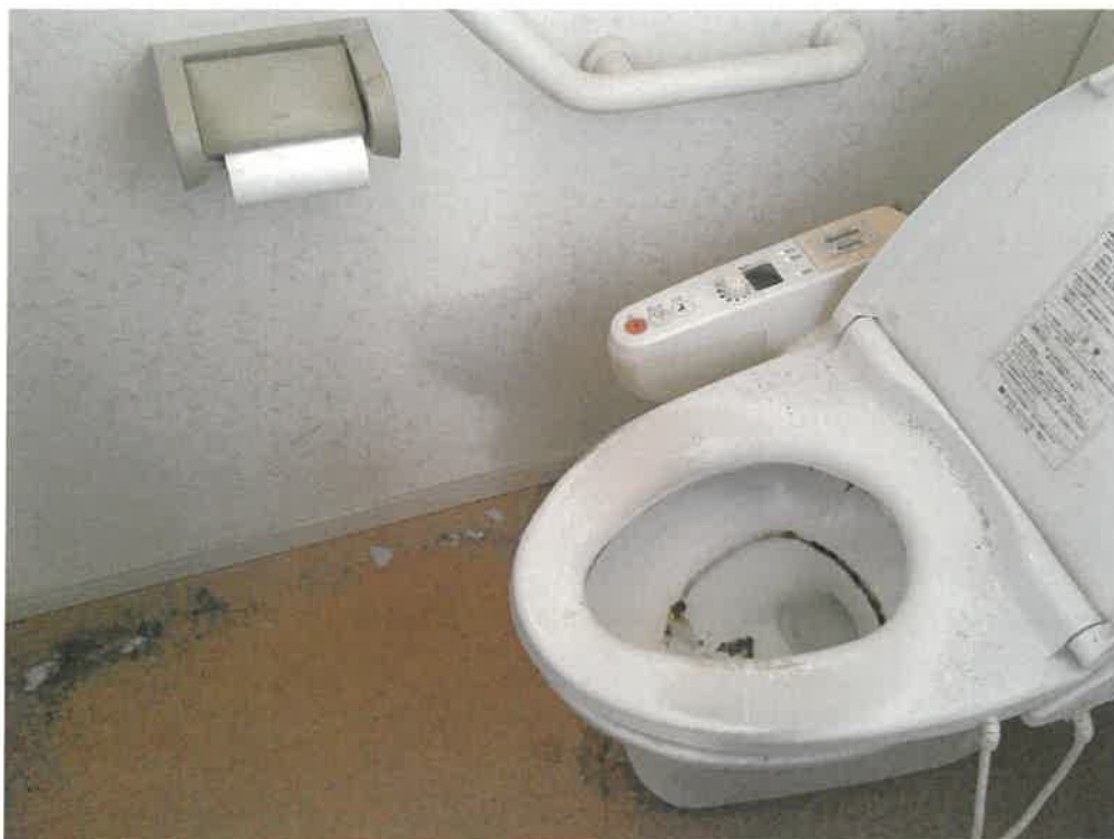
写真⑨(物件3 2階 トイレのカビ)
