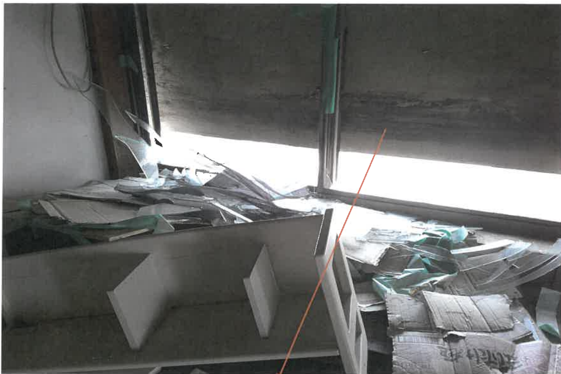
窓ガラスが壊れて代わりにベニヤ板で補修してある箇所
