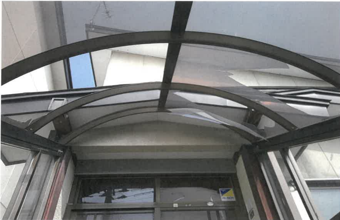
写真⑤(物件2 外階段囲いの屋根の破損箇所)
