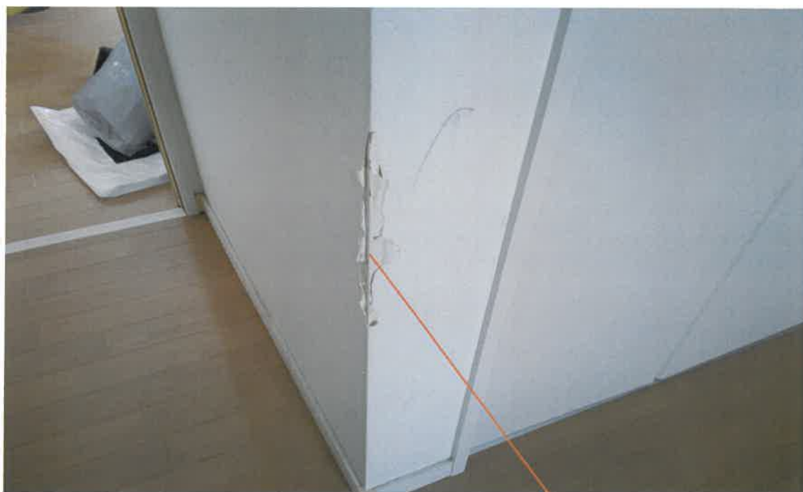
写真⑭(物件5 2階 洋室の壁)
