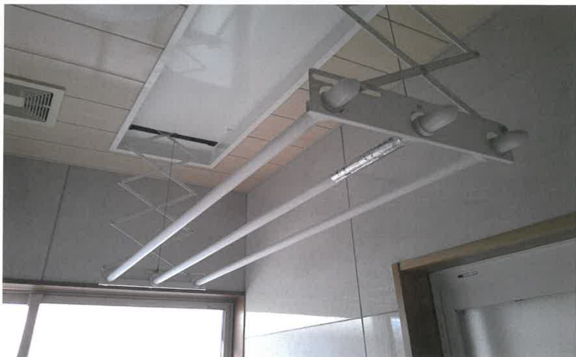
写真⑯(物件3 1階 洗面脱衣室天井 電動物干器)
