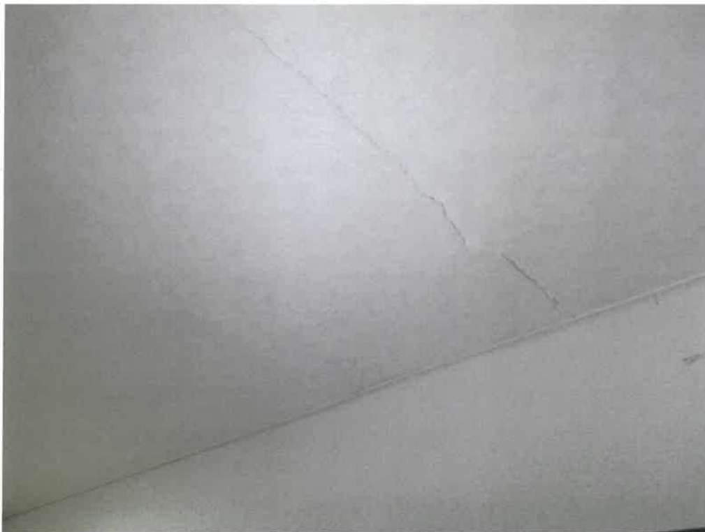
写真⑧ (物件 2 2階 天井のクロスが剥がれ)
