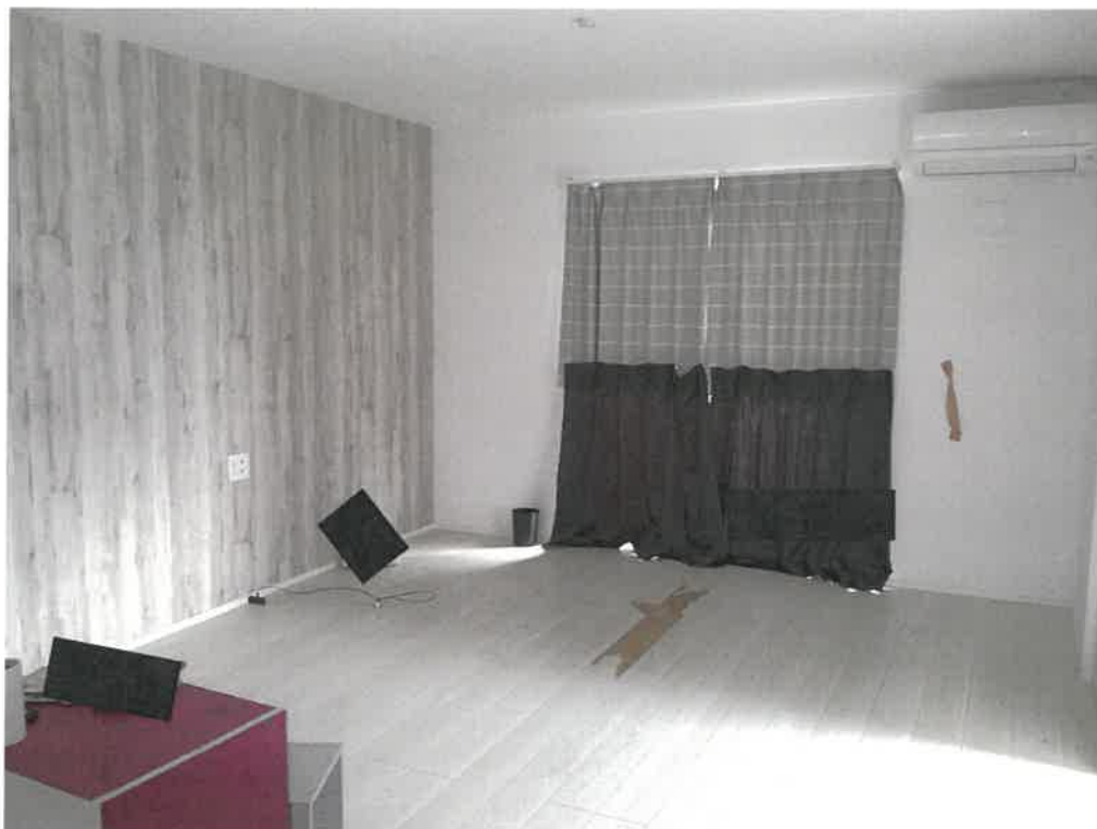
写真③(物件2 リビング・ダイニング (と床の剥がれ))
