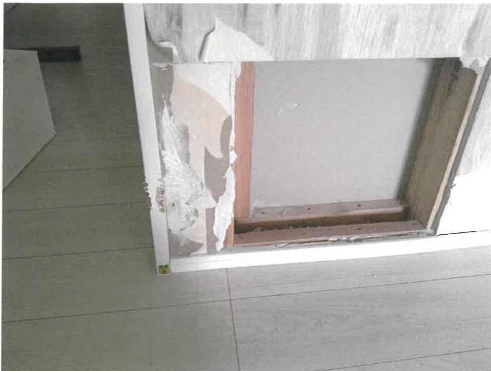
写真⑤ (物件2 内壁の破損)
