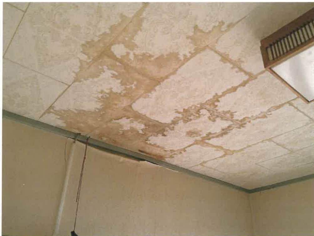
写真⑫ (物件2 1階 玄関天井の雨漏り跡)
