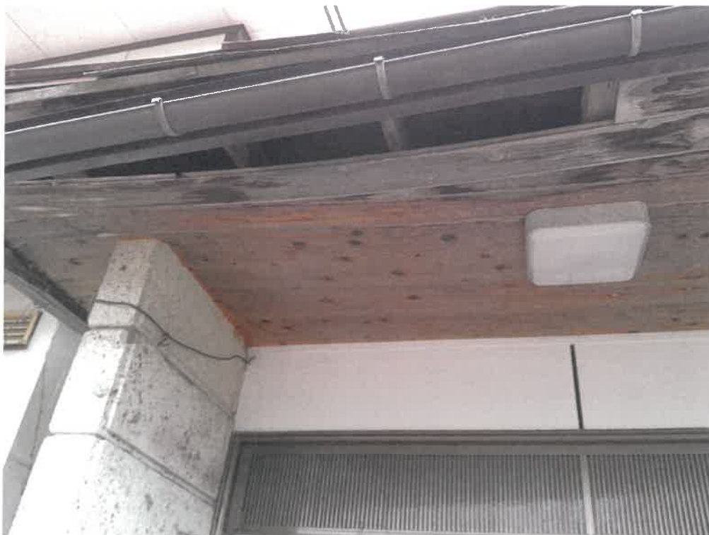
写真⑭(物件2 玄関下屋の天井部分の破損 )
