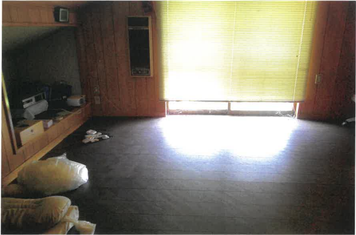
写真⑤(物件 8 3階 物置)
