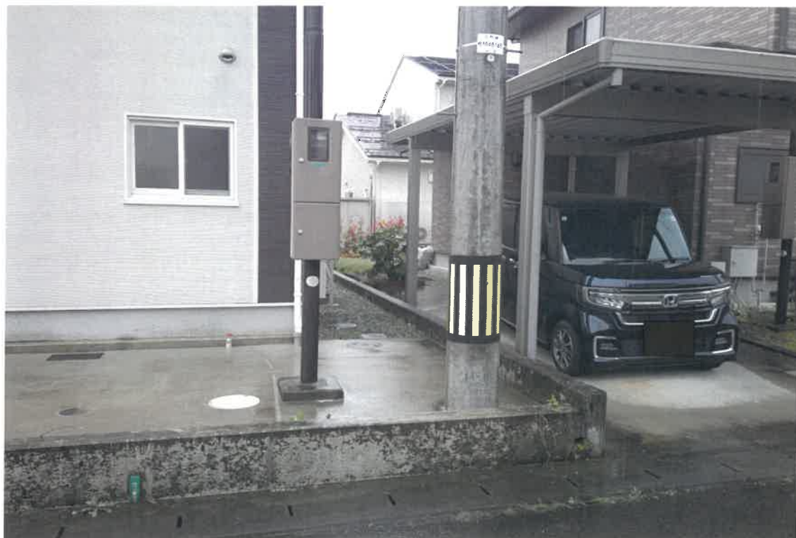
写真⑭(物件1 北側接道付近 電柱とソーラーシステム売電用ポール)
