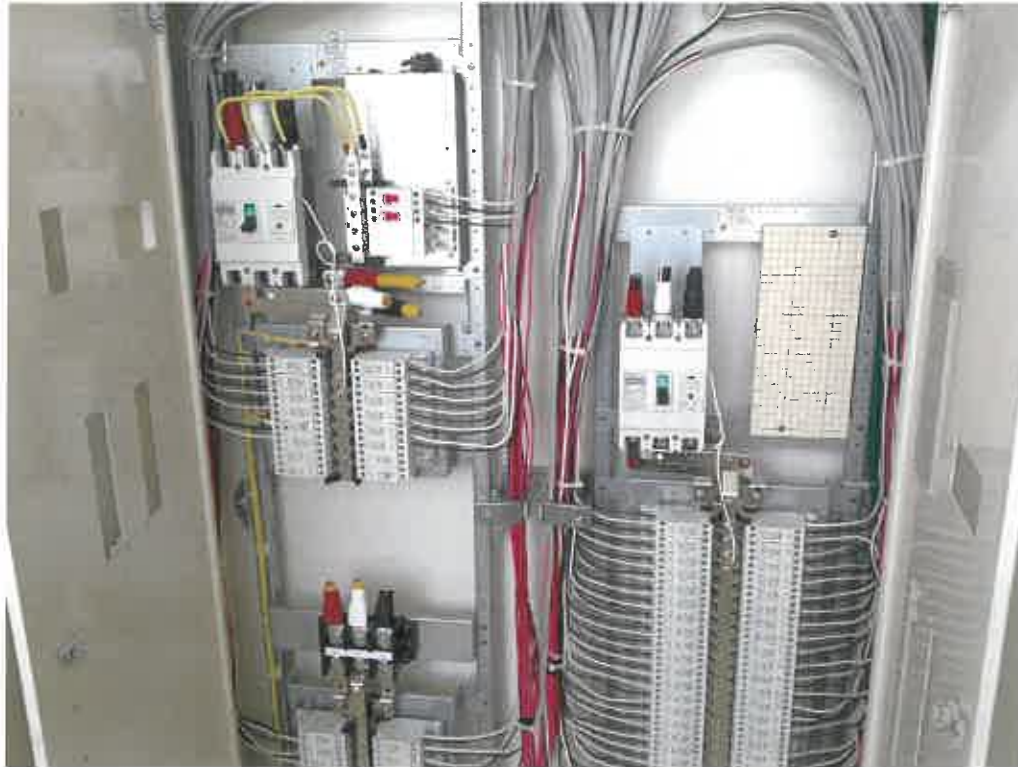
写真⑨ (物件4 1階 分電盤)
