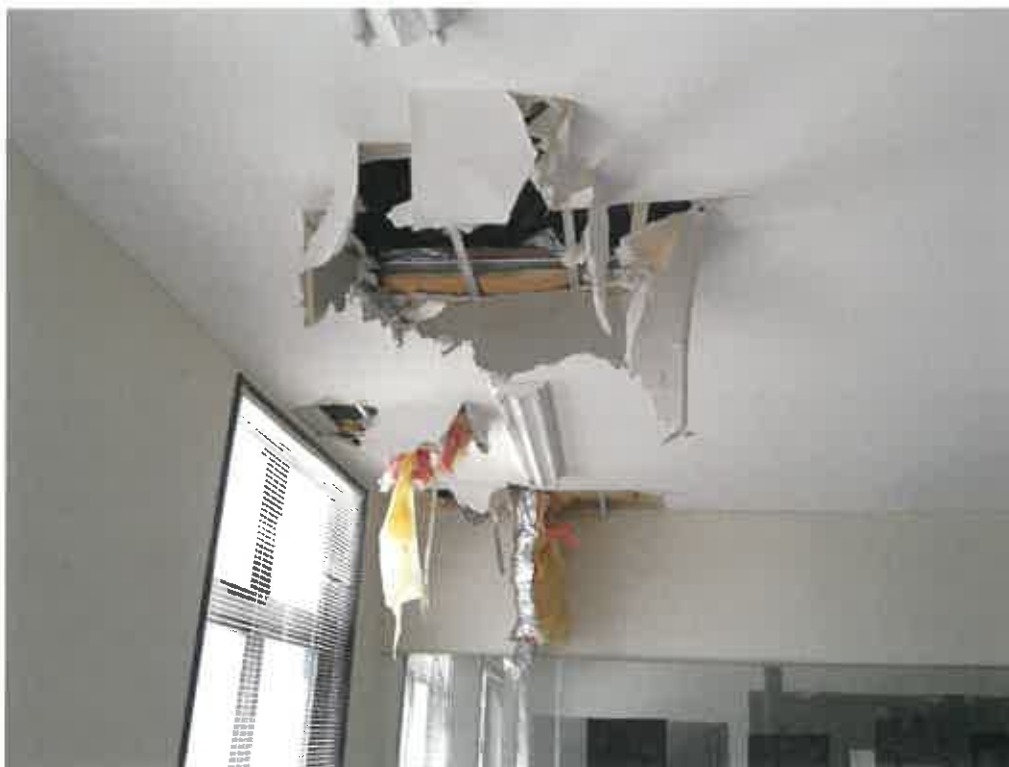
写真④(物件4 1階(食堂・機能訓練室) 天井)
