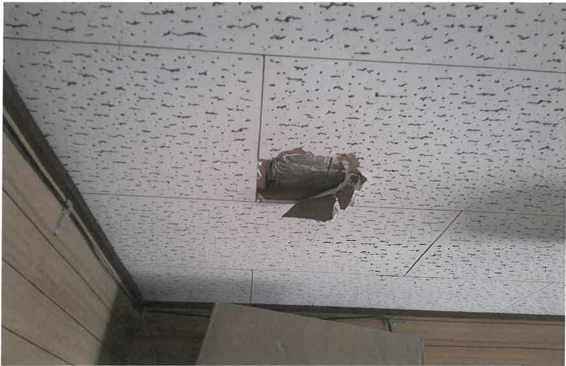
写真㉑(物件3 3階 洋室の天井破損箇所)
