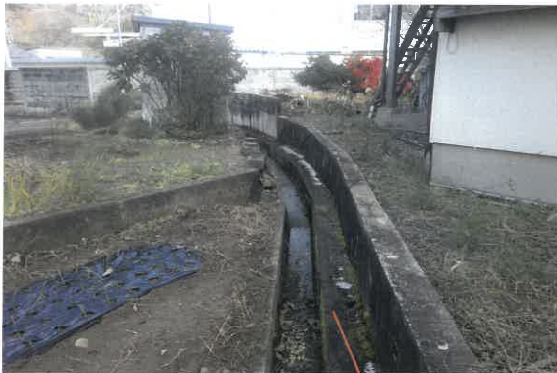
水路の縁が広がっている
