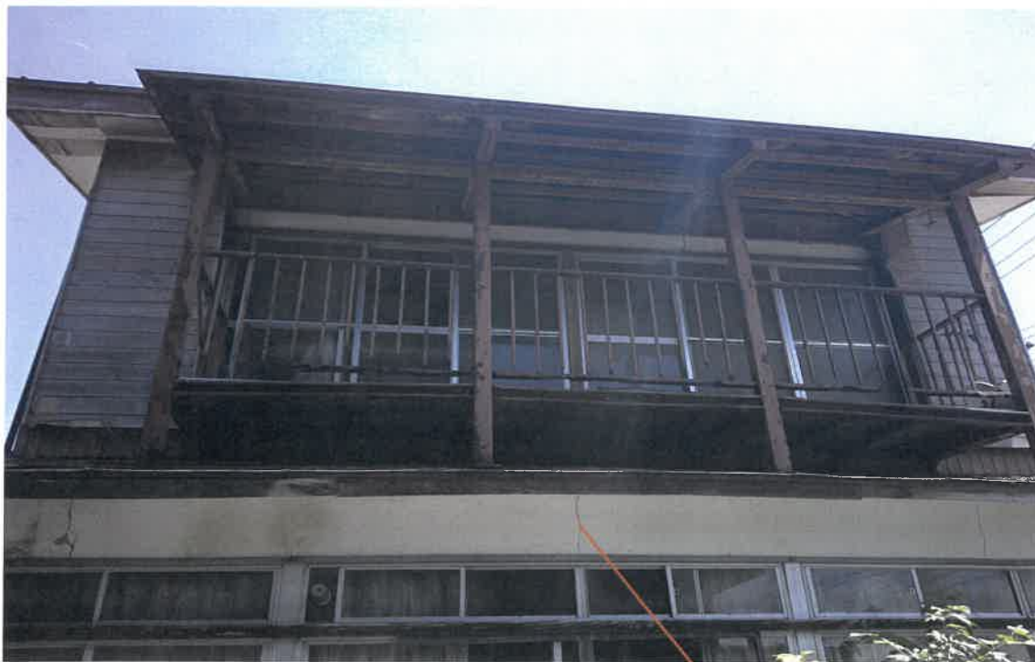
1階の軒下数か所にひび割れがある ( 17 枚目)
