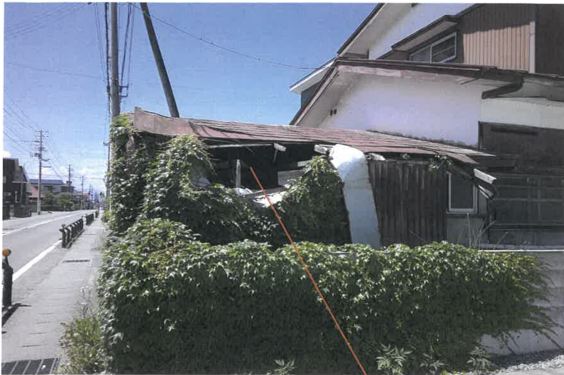
物置の屋根と軒下が破損している
