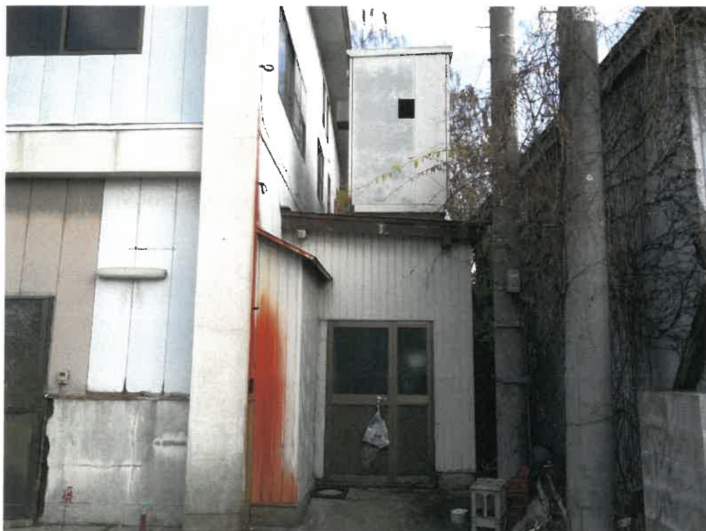
写真④(物件4 冷却ダクト)
