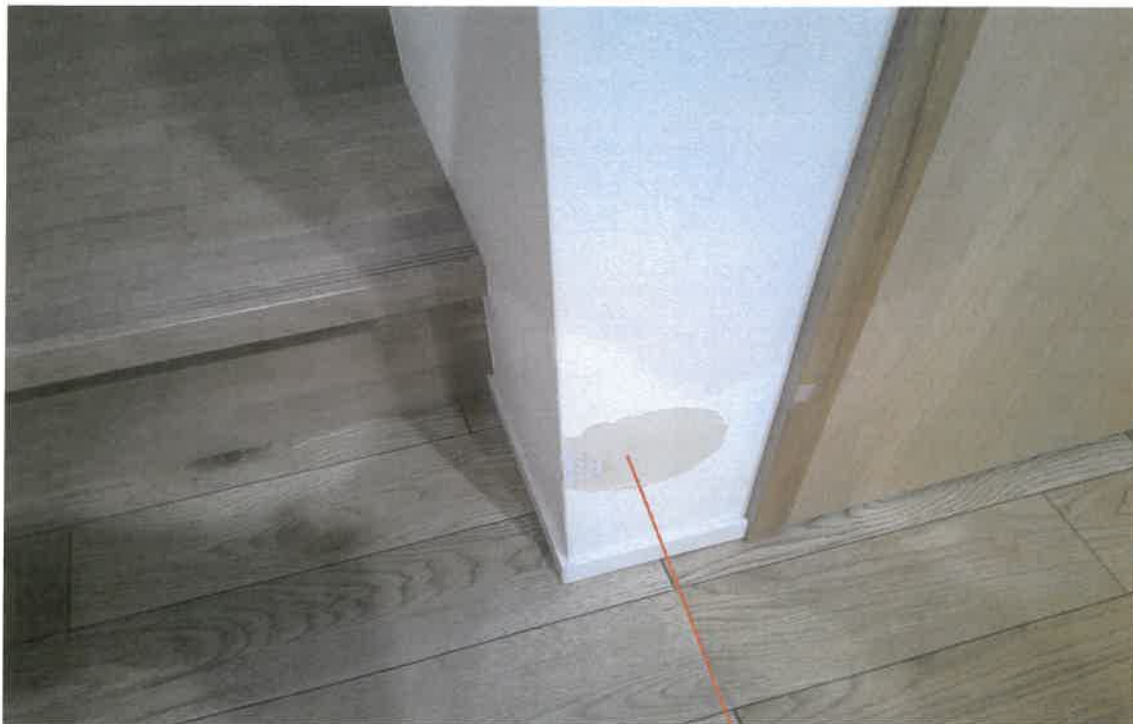
ペットの犬が引っ掻いてできた柱の傷
