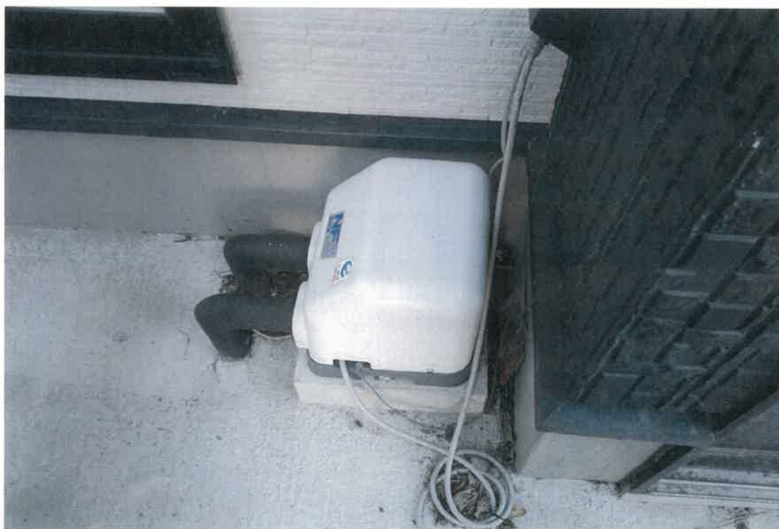
写真④(物件1 家庭用地下水ポンプ)
