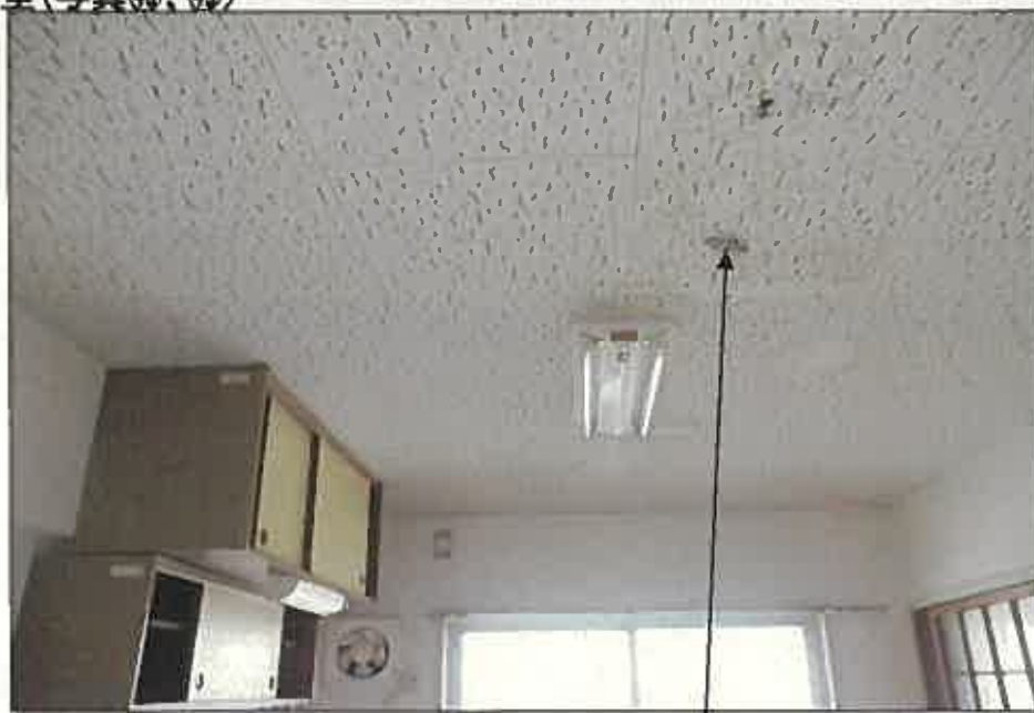
雨漏りの発生
