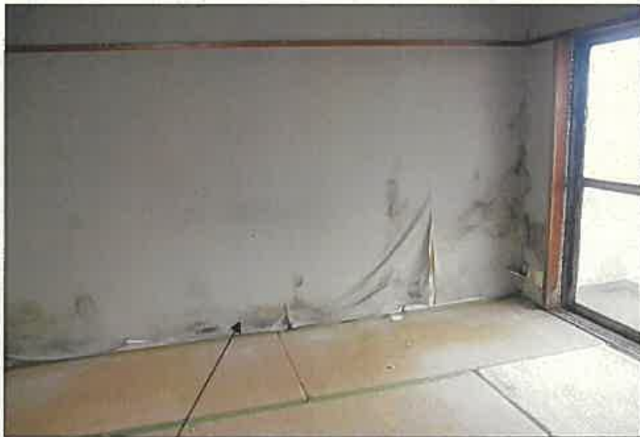
壁クロスの損傷
