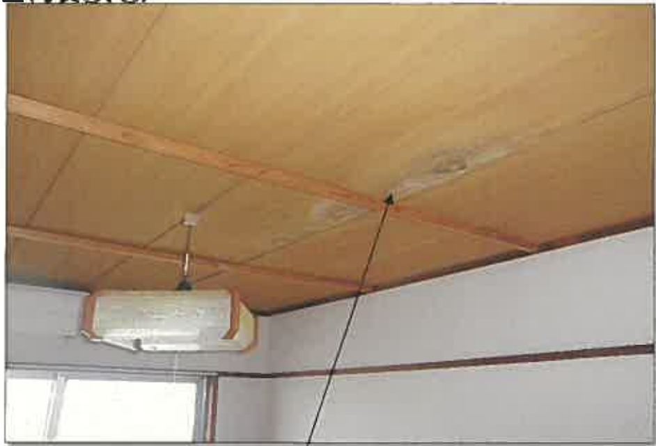
雨漏りの発生 屋上防水の剥離
