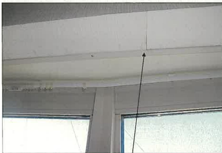
雨漏りが発生している。 ( 12 枚目)
