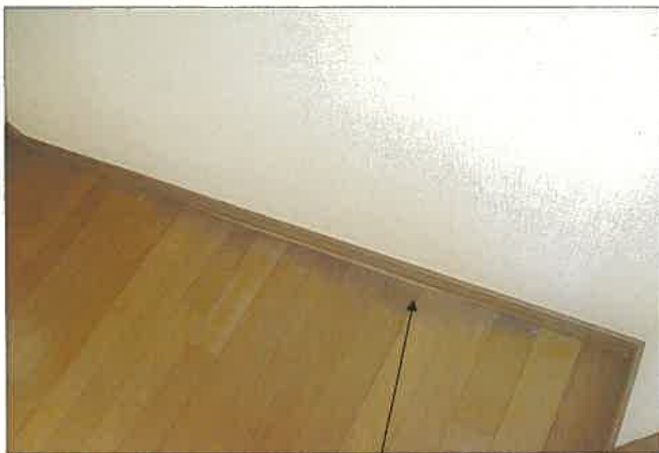
床の腐食 ( 11 枚目)
