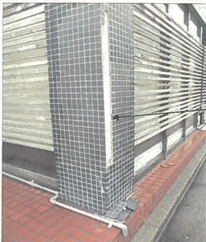
外壁タイルの剥離
