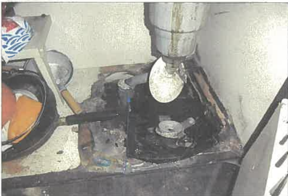
排水管の損傷により階下に大量の排水が漏れた箇所 ( 25 枚目)
