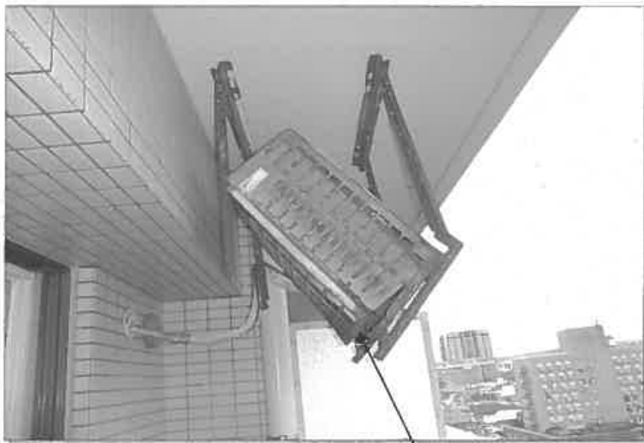
エアコン室外機・天吊り用架台の腐食
