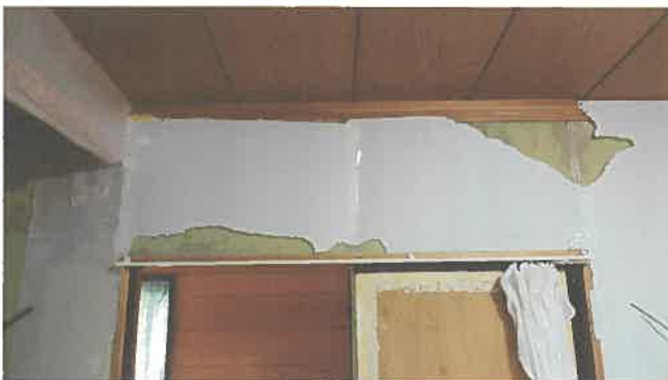
前同（飼育しているペットによる内壁等の損傷）
