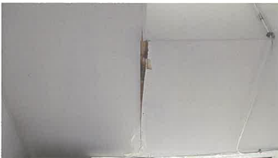
前同（天窓下の天井クロスの一部剥がれ）
