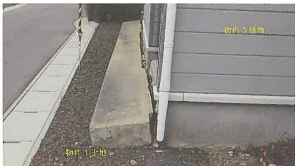
亀裂が生じている
