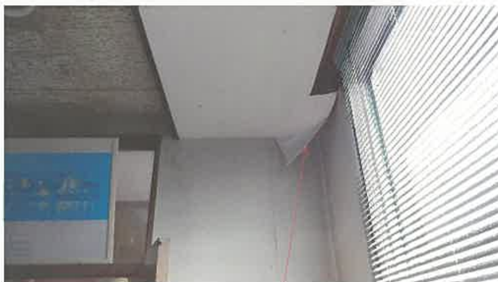
前同（雨漏りによる天井クロスの一部損傷）
