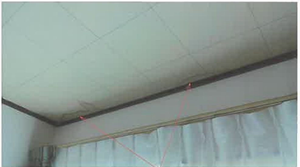
前同（2階浴室の水漏れによるしみ）
