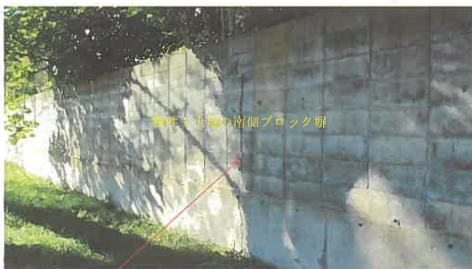
亀裂が生じている
