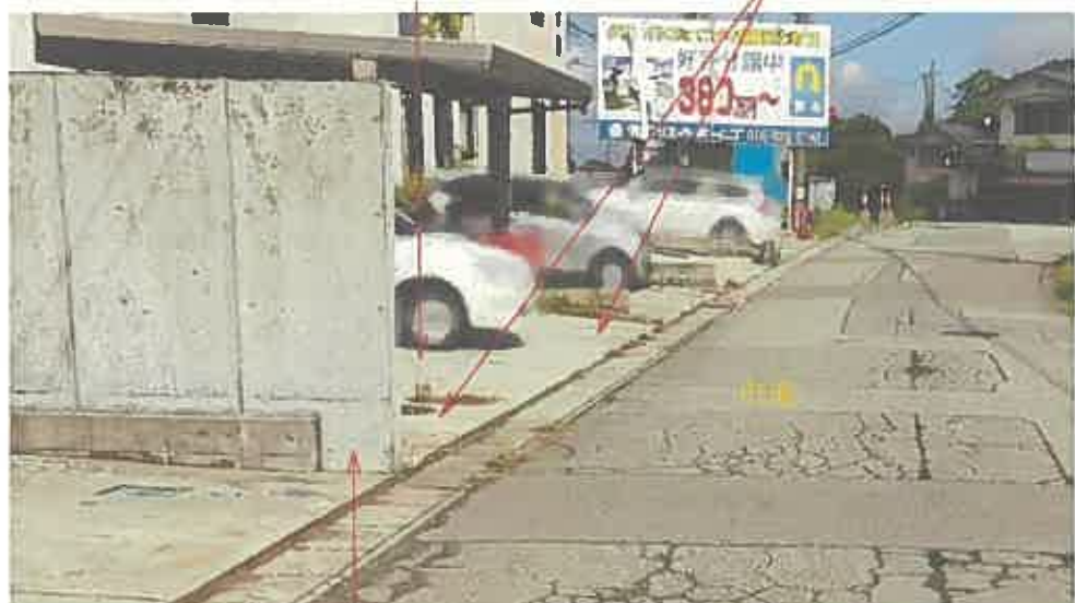
市道敷にはみ出しているコンクリート塀の南東端部分
