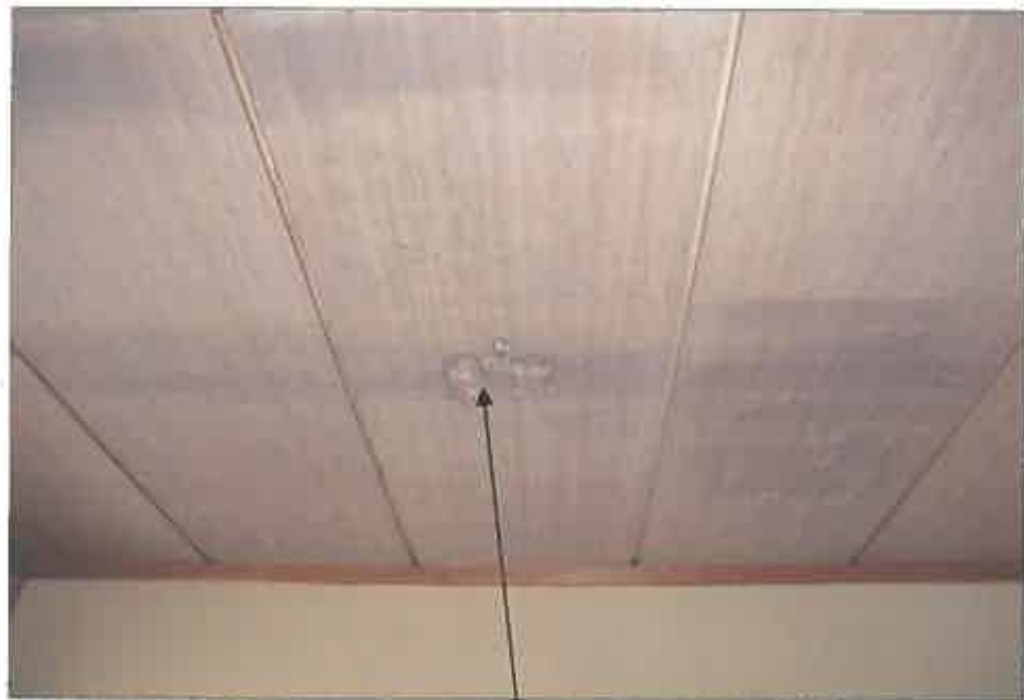
雨漏りの跡 ( 12 枚目)
