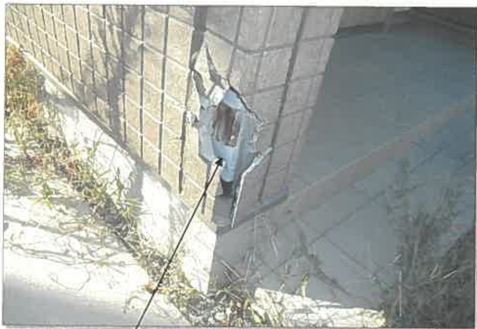
外壁の破損 ( 8 枚目)
