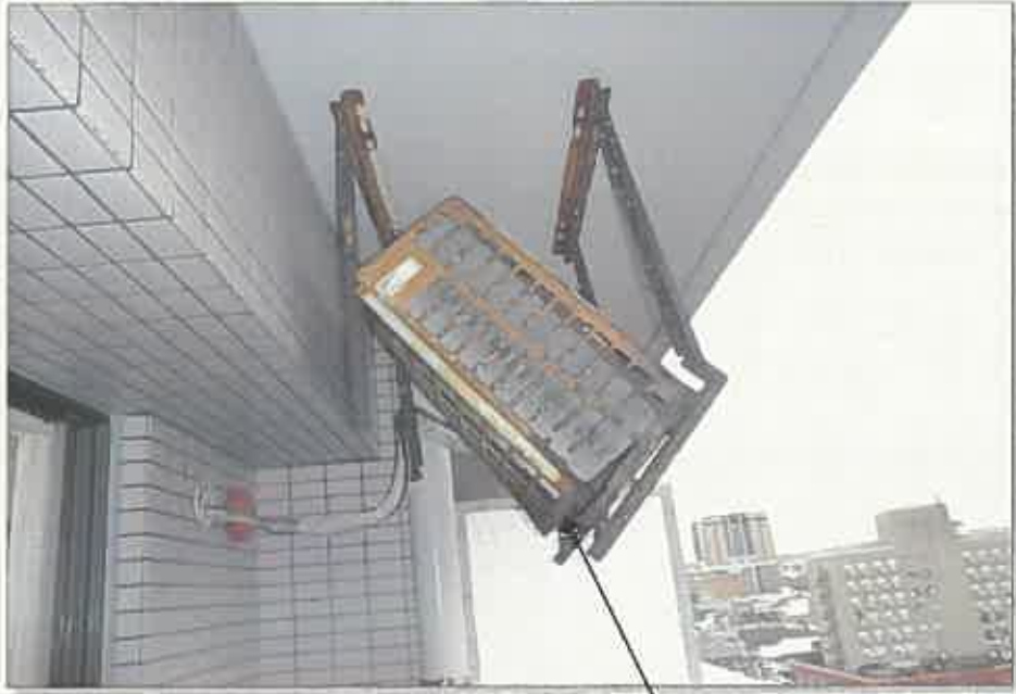
エアコン室外機・天吊り用架台の腐食
