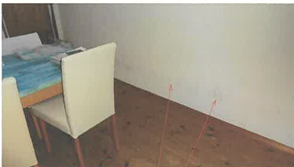
前同 (内壁の汚れ、損傷)
