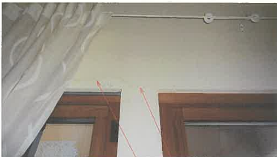
前同（内壁の汚れ、亀裂）
