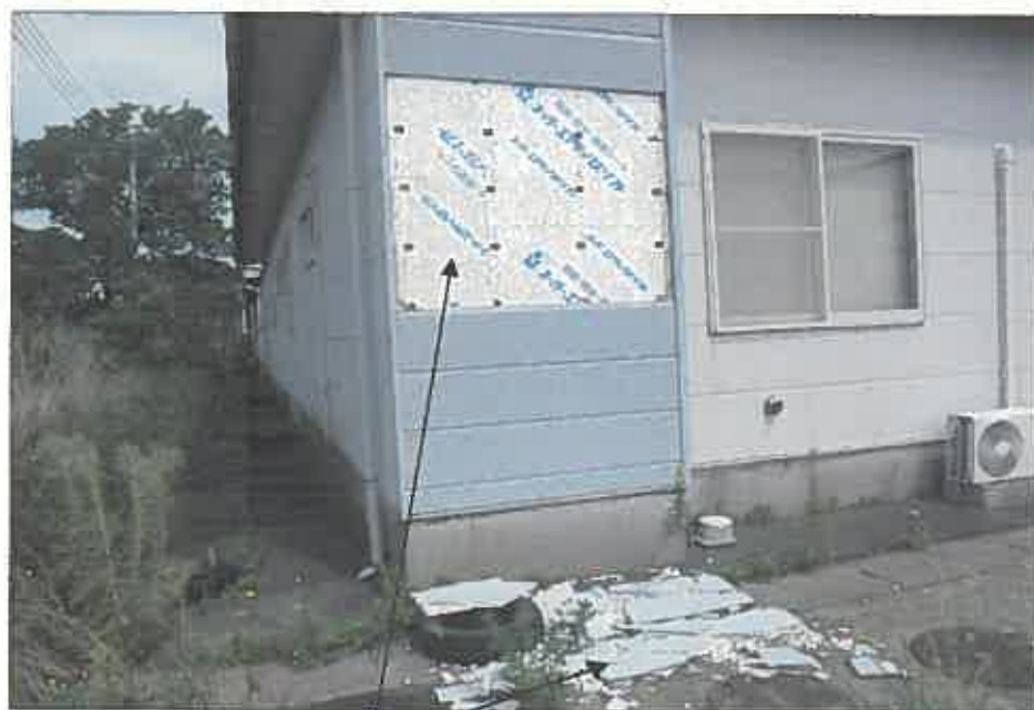
外壁の剥離 ( 10 枚目)
