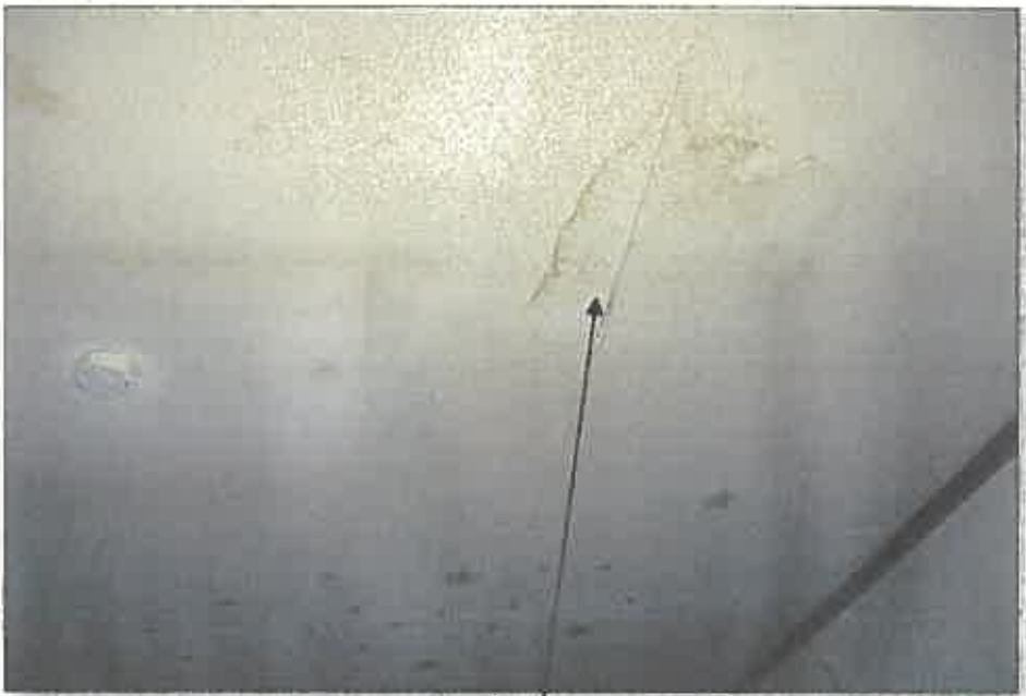
雨漏りの跡 ( 14 枚目)
