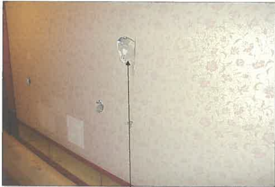
壁の損傷 ( 24 枚目)
